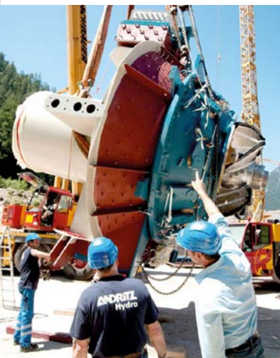
Central Hidroeléctrica Embalse Ancoa 2 x 13 MW Francis Turbine
